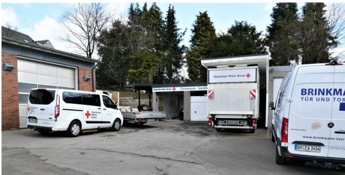
Das DRK hat in den bestehenden Räumlichkeiten bereits mit dem Umbau begonnen. Der Anbau kann erst starten, wenn das alte Feuerwehrhaus weg ist.
